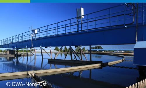
Kläranlage Paide, Estland
