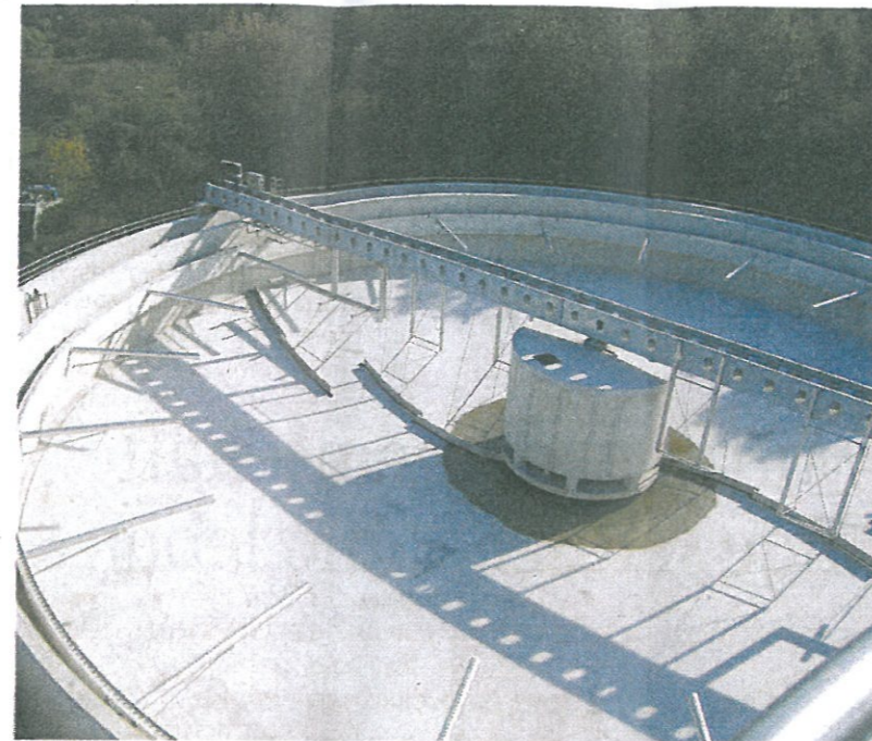
Neue Anlage im Klärwerk: Im Inneren des Rings liegt das Sedimentationsbecken, außen das umlaufende Reaktionsbecken. FOTO: ZWECKVERBAND KLÄRANLAGE BÖBLINGEN-SINDELFINGEN
